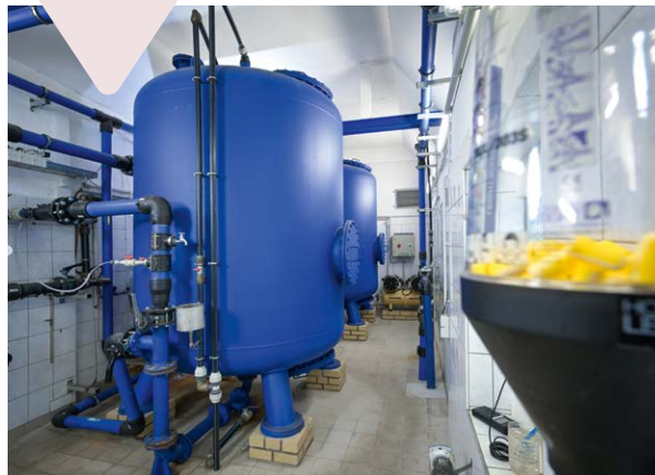
Hier kommt das Lebensmittel Nummer 1 her: Im Wasserwerk Oelsig wird das Trinkwasser für die Region aufbereitet.
