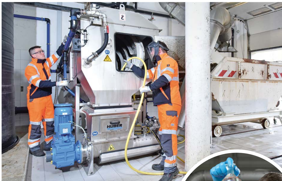
Sebastian Pfaff (li.) und Marcel Ziechner sichern nicht nur in der Corona-Krise den Betrieb der Kläranlage Grimma.
